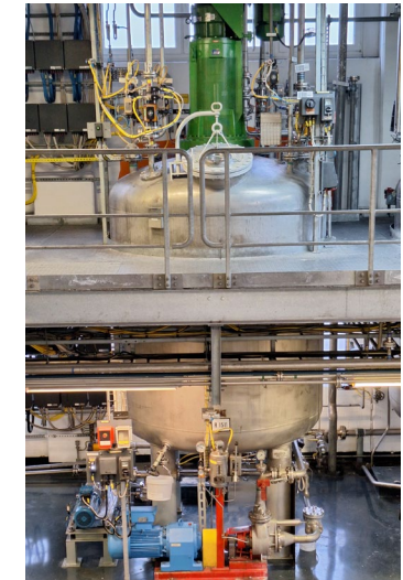
Circulation vessel (3 x 5,6 m 3 + 2 x 13,5 m 3 )
